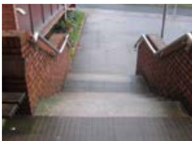
Escaleras de acceso en la entrada principal edificio rojo. No se dispone de rampa alternativa en estas escaleras.
