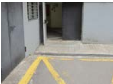
Puerta de acceso Hospitalización Domiciliaria, Edificio Amara. Ancho libre de paso inadecuado.
