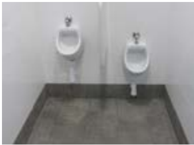
Aseo adaptado. Urinarios instalados adecuadamente.
