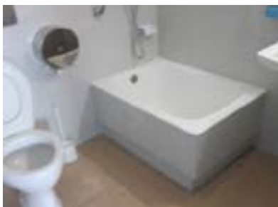
Baño habitación con bañera, completamente inaccesible. Edificio Materno-Infantil.
