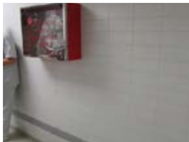
BIE sin proyección horizontal en itinerario peatonal que puede ser objeto de tropiezos con él.
