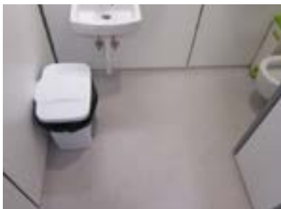
Hospital Gernika-Lumo. Aseo inaccesible. No permite el giro interior.
