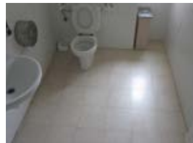
Aseo reservado, planta baja. Inodoro a altura inadecuada.
