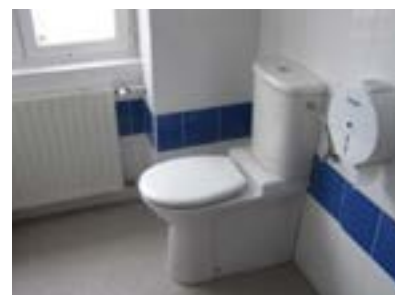
Aseo reservado, en hospitalización. Sin barras asideras.
