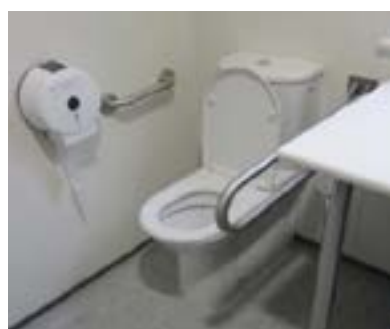
Hospital de Cruces. Edificio central. Aseo accesible inutilizado por la mesa.
