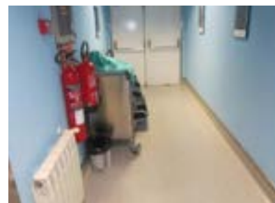
Hospital de Cruces. Pasillo del edificio central. Utilizado como sala de espera, estrecha demasiado el pasillo e impide el paso a usuarios de silla de ruedas al haber personas sentadas.
