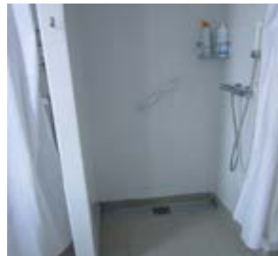
Baño asistido. No dispone de espacio adecuado, ni de barras asideras.
