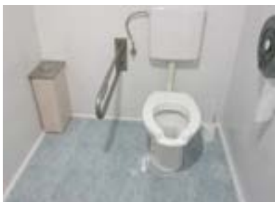
Aseo reservado en el área de radiología. Barra asidera solo a un lado.
