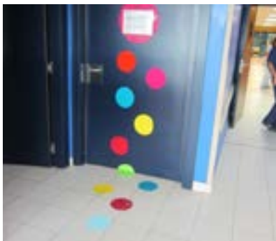
Puertas de urgencias con señalización inadecuada ya que no da información.
