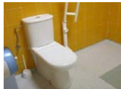
Hospital Universitario Donostia. Edificio Amara. Carece de barra asidera en un lateral.
