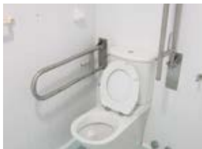
Aseo reservado. Alarma instalada a altura inadecuada.
