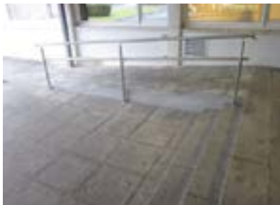
Rampa de acceso a la entrada principal. Pendiente elevada. Pasamanos solo en un lateral.
