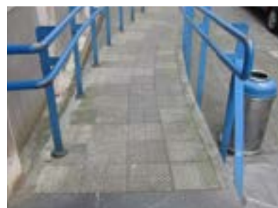
Rampa de acceso al ambulatorio. Ancho inadecuado.
