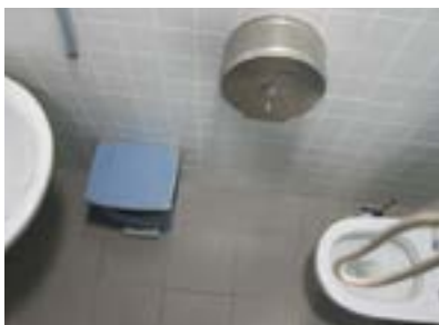
Aseo radiología. Inaccesible.
