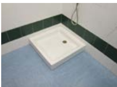
Ducha inaccesible en vestuario reservado de rehabilitación.
