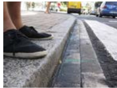
Escalón de acceso en paso de peatones.
