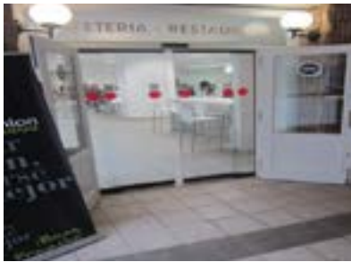
Cafetería. Puerta de acceso de ancho inadecuado.
