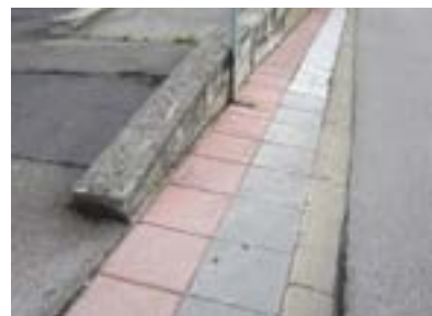
Acera con ancho insuficiente.
