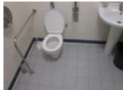
Hospital Santiago Apóstol. Servicio de urgencias. Aseo común adaptado. La barra asidera fija es un obstáculo que provoca tropiezos.
