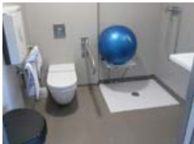
Habitación paritorio. Instalación de inodoro a altura inadecuada, falta de barras asideras en la ducha.
