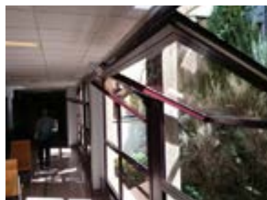
Ventanas en voladizo sin proyección horizontal que pueden ser peligrosas para cualquier persona.
