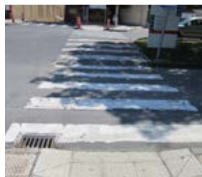
Pasos peatonales con desperfectos y vados mal realizados.
