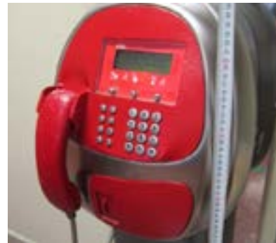
Teléfono público accesible. Se trata de un teléfono público estándar que se ha instalado a una altura adecuada.
