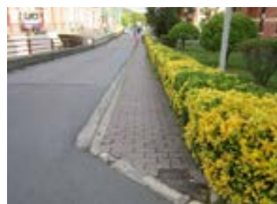
Acera estrecha y vado con escalón en acceso.
