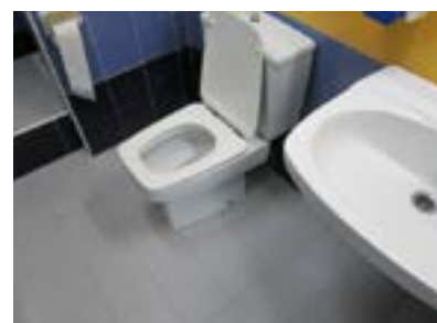
Hospital de Basurto. Edificio San Pelayo. No hay espacio lateral para transferencias.
