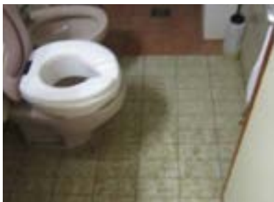
Baño habitación tipo, ducha cota "0", sin espacio de giro y transferencia.
