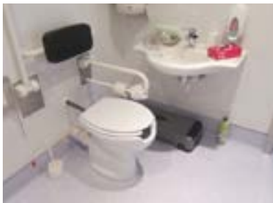
Baño accesible de zona de boxes. Espacio de acceso al lavabo inadecuado.
