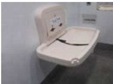
Aseo pediátrico. Cambiador instalado a altura adecuada.
