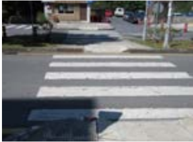
Hospital Galdakao-Usansolo. Isleta mal realizada.
