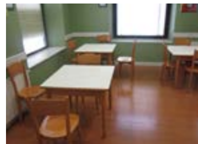
Comedor. Mesas con dimensiones inadecuadas.
