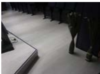
Salón de actos. Paso inadecuado.
