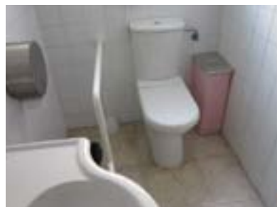
Aseo reservado. No permite realizar un giro en el interior, ni tiene espacio de transferencia al inodoro.
