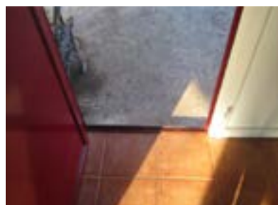
Caseta de máquinas expendedoras. Puerta de acceso con ancho inadecuado y escalón en acceso.
