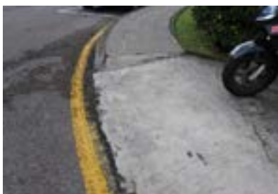
Vado peatonal con pendiente excesiva, sin señalización de paso, mal acceso desde el rebaje a la acera, etc.
