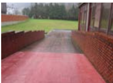
Entrada al edificio Rojo por la parte de atrás. Rampa con pendiente excesiva y sin barandillas.
