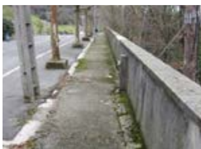
Acera de acceso a la cafetería, con ancho insuficiente y vegetación resbaladiza en itinerario.
