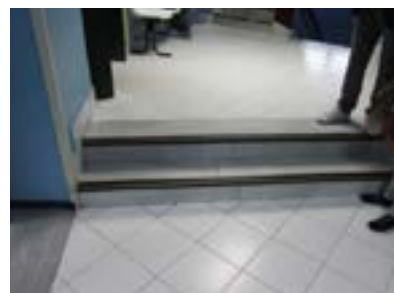
Hospital de Basurto. Edificio Arrupe. Acceso a sala de espera inaccesible.
