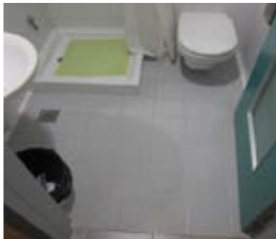
Baño tipo en habitación del edificio central. Ducha inaccesible e inodoro sin espacio de transferencia.
