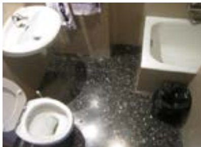
Hospital Santiago Apóstol. Bañera en aseo inaccesible.
