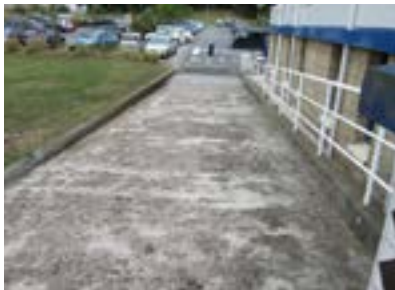
Acceso a playa. Pavimento deteriorado y sin pasamanos a ambos lados.
