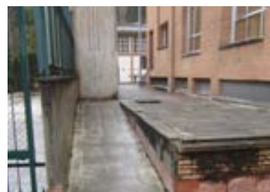
Rampa interior recinto hospitalario, pendiente inadecuada, no dispone de pasamanos...
