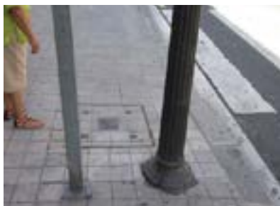
Franjas señalizadoras en paso peatonal, instaladas inadecuadamente.
