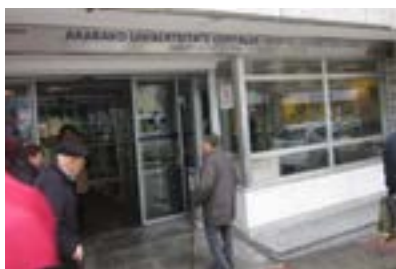
Entrada de consultas externas. Rampa antes de la puerta de acceso sin descansillo.
