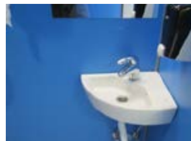
Aseo reservado. Lavabo sin fondo adecuado.
