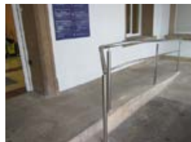
Rampa de acceso al edificio Amara. Ancho insuficiente y falta de contraste y pasamanos en todo el recorrido y a ambos lados.
