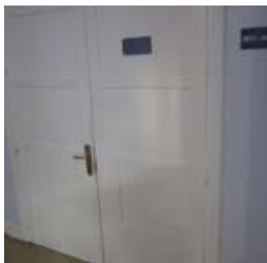
Puerta de acceso con ancho libre de paso inadecuado.
