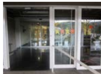
Hospital Galdakao-Usansolo. La barandilla no es adecuada. Puertas con señalización incorrecta.
