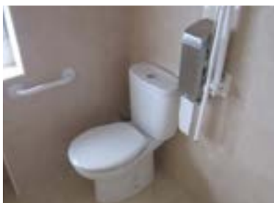
Aseo reservado en la planta primera. Inodoro inadecuado.
