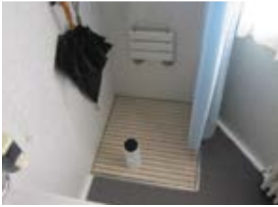
Habitación adaptada. Plato de ducha sin espacio adecuado de transferencia.
