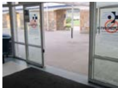
Puerta de entrada sin bandas señalizadoras.
