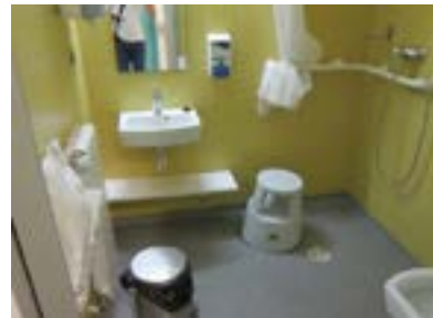
Baño tipo. Barra asidera en inodoro solo a un lado, lavabo sin fondo adecuado, espejo y secamanos a altura elevada... Edificio Amara.
