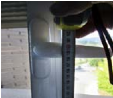
Hospital de Zumarraga. Habitación accesible. Ventana inaccesible.
