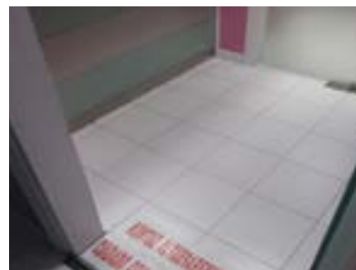
Recepción. Escalón en acceso, espacio insuficiente para realizar giro y mostrador sin adaptar.
