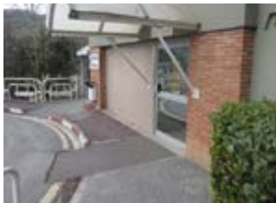
Desperfectos en acceso a la entrada principal y jabalcón sin proyección.
