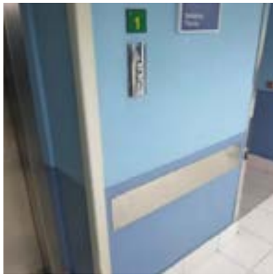
Hospital de Basurto. Edificio Arrupe. Pulsadores sin iluminación. No hay señalización en el suelo.
