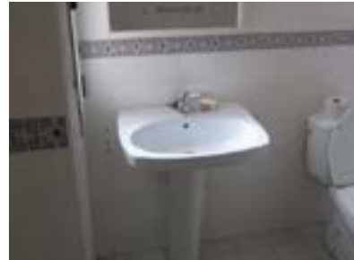
Hospital Psiquiátrico de Bermeo. Lavabo con pie. Inodoro sin espacio de traslado. Inaccesible.
