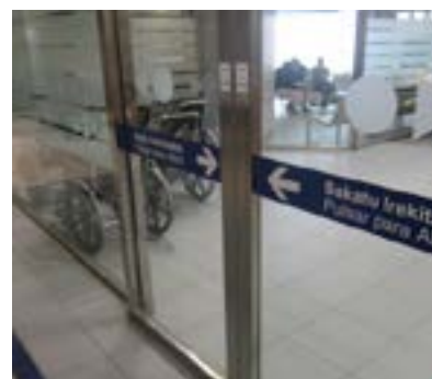
Puerta interior en la unidad de urgencias con mecanismo de apertura instalado a una altura elevada.
