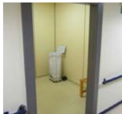
Vestuario adaptado de radiología. Espacio interior adecuado pero la puerta abre hacia dentro.
