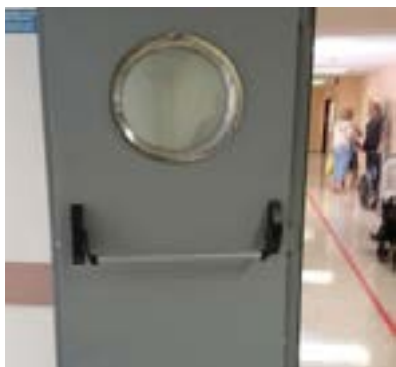
Puertas de doble hoja con ancho inadecuado y falta de otra barra a menor altura.
