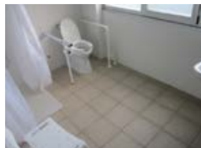
Baño comunitario adaptado en unidad de hospitalización.
