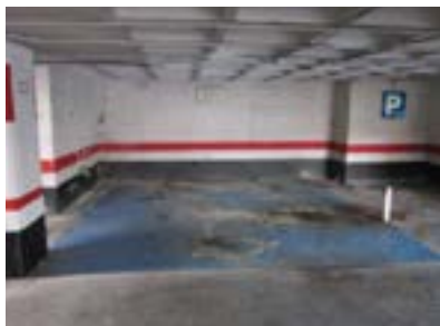
AG1. Señalización horizontal deteriorada. Falta señalización vertical.
