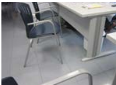
Consulta médica. No se dispone de espacio para realizar giro las personas usuarias de silla de ruedas, las mesas no disponen de fondo adecuado.
