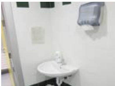
Accesorios de lavabo instalados a demasiada altura.
