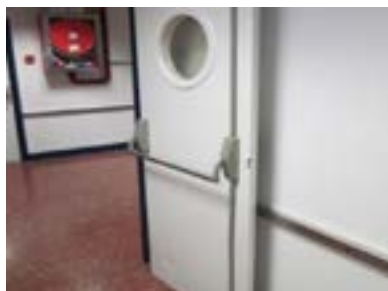
Puertas de doble hoja, con ancho libre de paso de cada una de las hojas, inadecuado.
