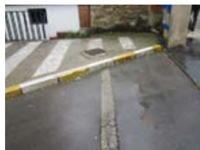
Acceso a aparcamiento. No dispone de vado peatonal adecuado.
