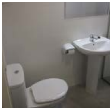
Baño tipo reformado de habitación. Presenta algunos problemas de accesibilidad.
