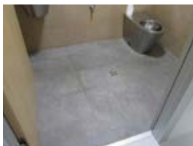
Aseo accesible, zona psiquiatría legal. Sin ningún tipo de adaptación.
