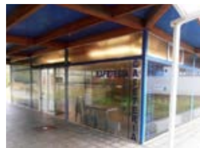
Cafetería. Puerta de acceso sin bandas de señalización.
