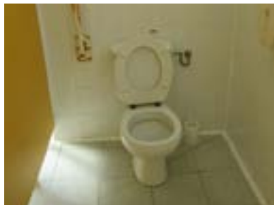
Aseo reservado deficiente en zona de piscina.
