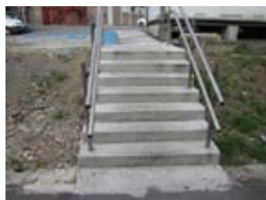
Acceso por la puerta trasera al recinto hospitalario, escalera sin rampa anexa.
