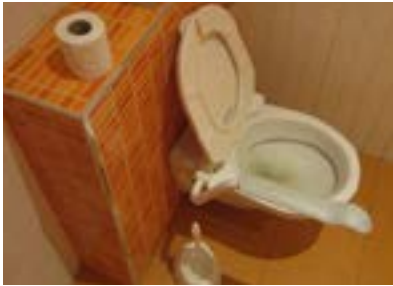
Aseo reservado en la zona de cafetería. Barras asideras y mecanismo de descarga inadecuados.
