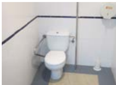
Barras asideras inadecuadas en aseo reservado.
