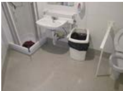
Baño habitación adaptada, con plato de ducha y mampara, que los hacen inaccesibles.
