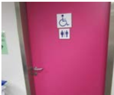
Puerta de apertura hacia dentro del baño en boxes.
