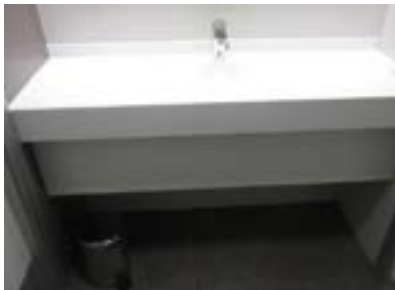
Aseo reservado en la unidad de traumatología. Lavabo sin fondo adecuado.
