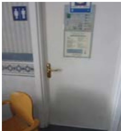
Puerta de acceso con apertura hacia el interior del aseo.
