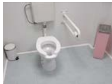
Aseo reservado en zona de consultas, calle La Esperanza. Barra asidera solo a un lado.
