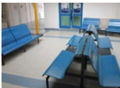
Sala de espera sin espacio reservado a personas usuarias de silla de ruedas.
