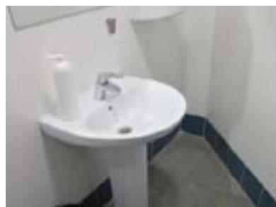
Lavabo con pedestal en aseo reservado, zona urgencias.
