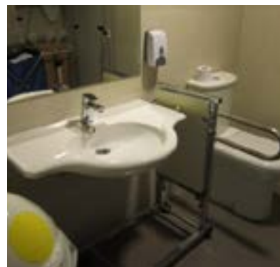
Aseo adaptado. Sin espacio de transferencia, lavabo sin fondo adecuado y espejo a altura elevada.
