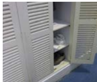
Hospital Psiquiátrico de Bermeo. No hay espacio de acercamiento frontal para silla de ruedas.
