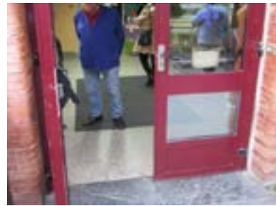
Puerta con ancho libre de paso inadecuado (la que abre primero).
