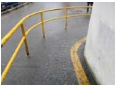
Acceso a urgencias. Pendiente y ancho inadecuados.
