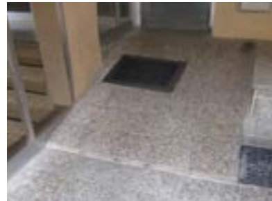
Rampa de acceso al edificio de las monjas, pendiente del 22%. Sin barandillas.
