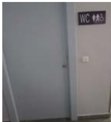
Puerta de acceso a aseo reservado, unidad de urgencias, paso libre de la puerta inadecuada y sin contraste cromático.
