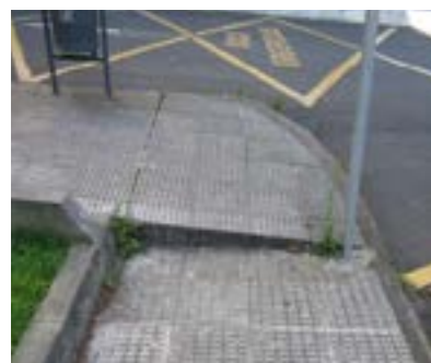
Escalón en itinerario peatonal.
