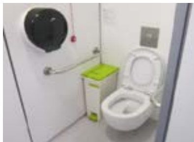
Hospital Gernika-Lumo. Aseo estrecho inaccesible.
