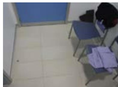
Vestuario adaptado. Puerta de apertura hacia dentro, espacio inadecuado para realizar giro.
