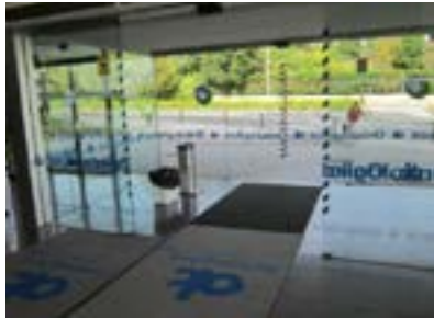
Puertas de entrada principal sin bandas señaladoras adecuadas.
