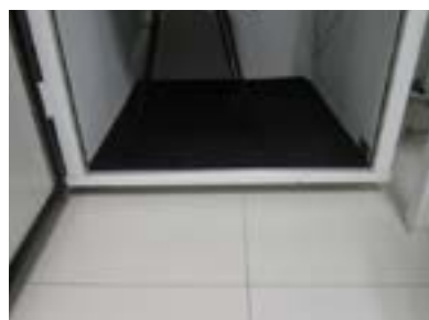
Acceso a cabina con escalón.
