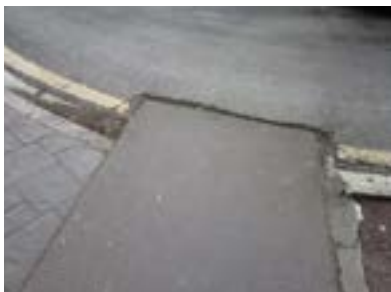
Rampa de acceso a urgencias. No permite realizar giro a personas usuarias de silla de ruedas. Suelo metálico, deslizante.
