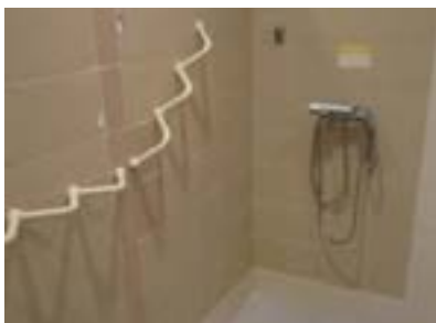
Hospital Psiquiátrico de Bermeo. Falta barra para modificar la altura del surtidor de agua.
