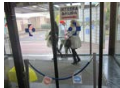
Puerta de acceso principal. No dispone de bandas señalizadoras y el felpudo provoca ceja.
