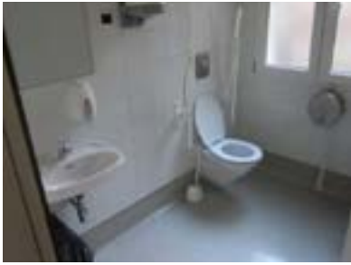
Aseo adaptado. Accesorios de lavabo y espejo instalados inadecuadamente.
