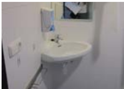
Aseo habitación adaptada. Lavabo sin fondo adecuado, espejo y papel seca manos a altura elevada.
