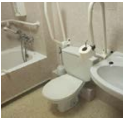
Baño habitación sin adaptar adecuadamente.
