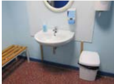
Aseo unidad de diálisis, con deficiencias de accesibilidad.
