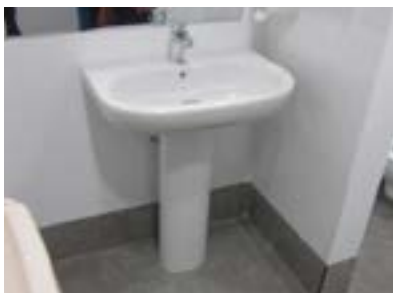
Aseo pediátrico. Lavabo con pedestal.
