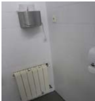
Accesorios de lavabo instalados a altura elevada.
