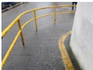
Acceso a urgencias. Ancho y pendiente de rampa inadecuado.
