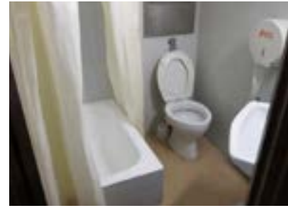
Baño con bañera completamente inaccesible. Edificio Materno-Infantil.
