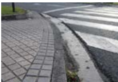
Vado peatonal mal resuelto.
