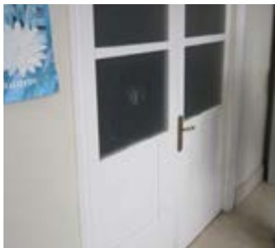
Puerta de acceso de doble hoja, con ancho inadecuado en la hoja que abre primero.
