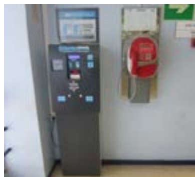
Hospital Galdakao-Usansolo. Máquina expendedora de tarjetas de TV. No se cumple con las alturas adecuadas.
