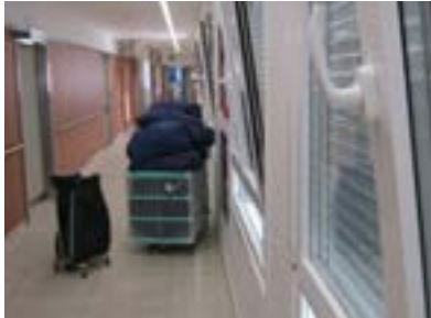
Ventanas en voladizo sin proyección horizontal en itinerario peatonal. Edificio Arantzazu.
