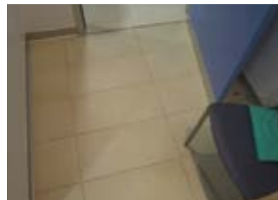
Vestuario adaptado. Puerta de apertura hacia dentro, espacio inadecuado para realizar giro.
