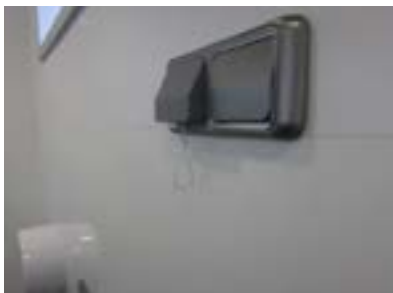
Aseo adaptado. Alarma tirador inadecuado.
