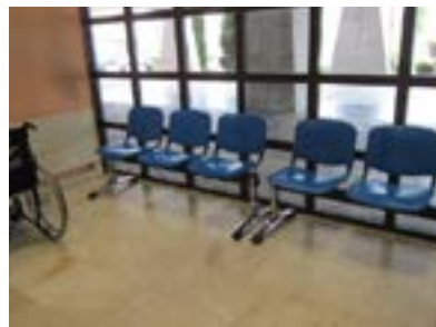
Sala de espera edificio A sin zona reservada para personas usuarias de silla de ruedas ni asientos adecuados para personas con movilidad reducida.
