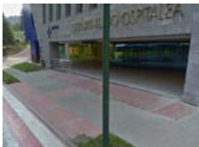
Rampa en acceso principal. Pavimento de señalización inadecuado.
