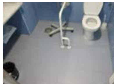
Baño habitación adaptada. Se instala barra fija, la cual impide la transferencia a usuarios de sillas de ruedas, por otro lado, el inodoro y lavabo no son adecuados. Edificio Arantzazu.
