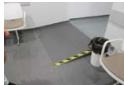
Oncológico. Acceso a aseo por medio de rampa con pendiente peligrosa.
