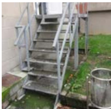
Hospital Psiquiátrico de Bermeo. Escaleras sin contrahuella. Escalones estrechos.
