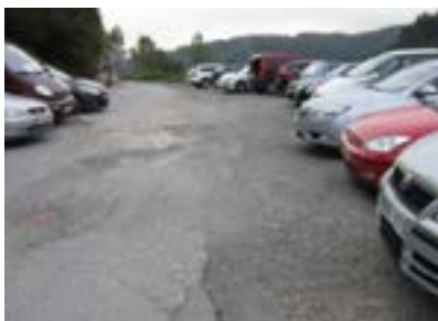
Aparcamiento con pavimento muy deteriorado.
