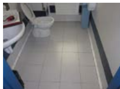
Aseo reservado. Superficie interior reducida, inodoro bajo, barras asideras inadecuadas.
