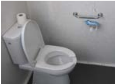
Habitación adaptada. Inodoro sin barras asideras a ambos lados y sin altura adecuada.
