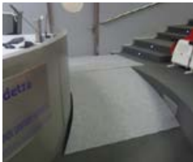
Salón de actos. Rampa con pendiente pronunciada.
