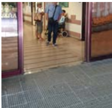
Puerta de acceso a urgencias sin bandas de señalización.
