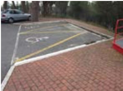
Plazas reservadas. Itinerario inaccesible hasta la entrada principal. Falta señalización vertical.
