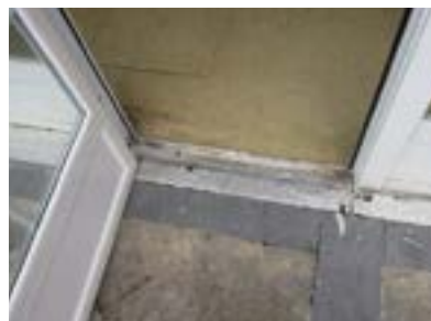
Puerta de acceso a la unidad rehabilitación 4. Escalón en el marco de la puerta y ancho de puerta inadecuado.
