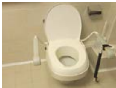
Inodoro con complemento alza inodoros. Inestable.
