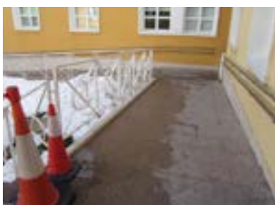
Rampa de acceso de la entrada principal con demasiada pendiente.
