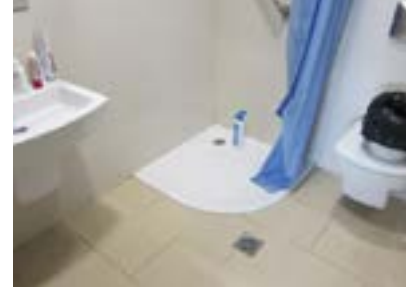
Habitación adaptada. Plato de ducha con escalón, lavabo sin fondo adecuado, y no se instalan ayudas técnicas. Edificio Psiquiatría unidad adultos.
