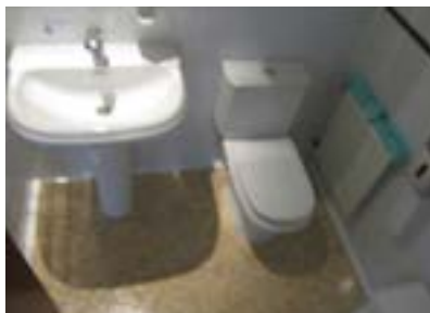
Aseo del hospital de día. Aseo sin adaptar. Inaccesible.
