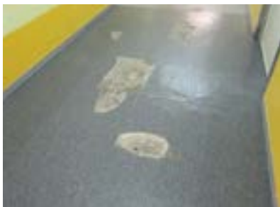
Cejas en solado. Edificio Arantzazu.
