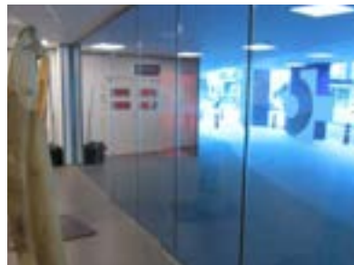
Cerramiento de vidrio sin bandas señalizadoras.
