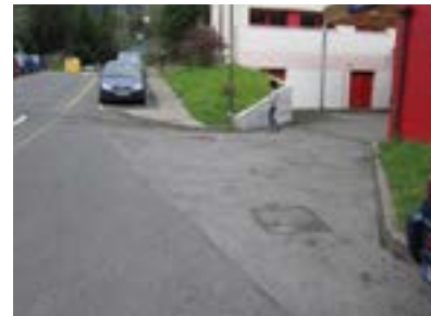
Acera sin vado de acceso a la zona de urgencias.
