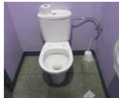
Aseo común en el pabellón Allende. Inaccesible.
