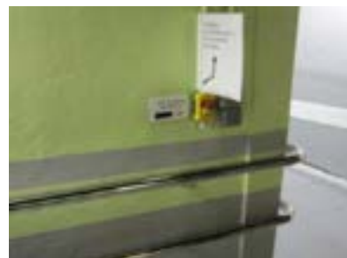
Botón de apertura de la puerta de acceso. Instalado a altura excesiva.
