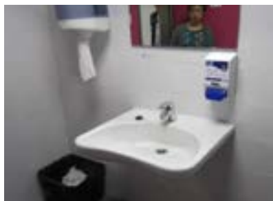
Hospital Galdakao-Usansolo. Lavabo adecuado. Espejo y papel alto.
