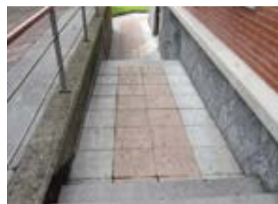
Escaleras en itinerario peatonal sin rampa alternativa.
