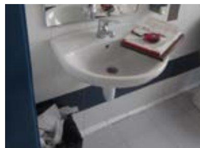
Lavabo sin fondo adecuado. Papel secamanos alto y espejo instalado inadecuadamente.
