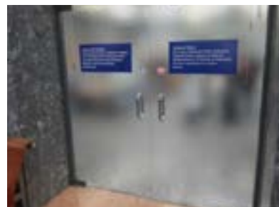
Hospital de Cruces. Puerta acristalada sin zócalo protector, ni señalización adecuada.
