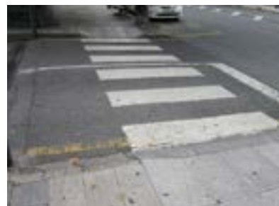
Paso peatonal con vados de acceso con pendiente excesiva.
