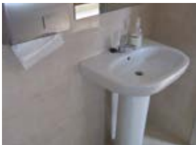
Aseo reservado en la planta primera. Lavabo y accesorios de lavabo inadecuados.
