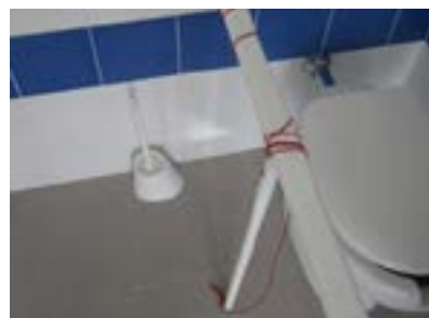
Baño en habitación adaptada. Alarma enrollada inaccesible.
