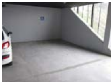
Plaza aparcamiento reservada sin señalización horizontal adecuada.
