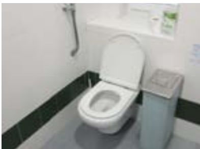
Aseo adaptado. No dispone de barras asideras e instalación de fluxor a altura y situación inadecuadas.
