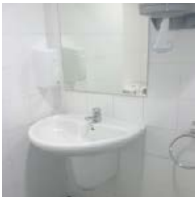
Aseo adaptado. Papel secamanos a altura elevada y lavabo sin fondo adecuado.
