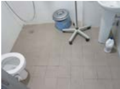
Baño plato de ducha cota suelo, no se permite realizar giro a personas usuarias de silla de ruedas, no dispone de ninguna ayuda técnica... Edificio Gipuzkoa.
