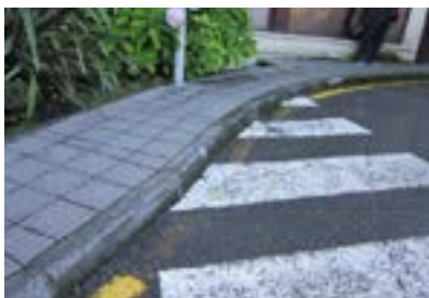
Acera con ancho insuficiente, paso peatonal inaccesible.
