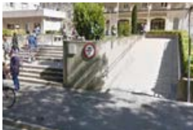
Rampa de acceso a la entrada principal con pendiente excesiva.
