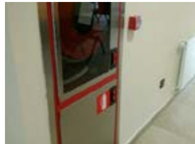
BIE, extintor y alarma de incendios instalados a una altura adecuada.
