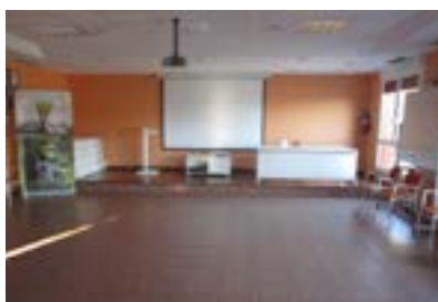
Pabellón Sala Polivalente. Estrado con escalón, inaccesible a personas usuarias de silla de ruedas.
