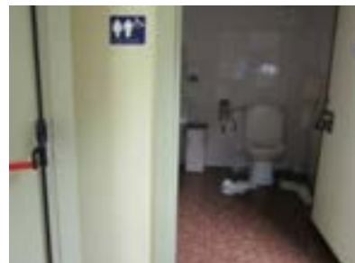
Apertura de la puerta hacia el interior del aseo adaptado, impidiendo la movilidad en el interior.
