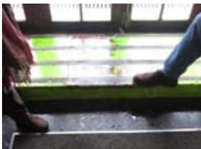
Acceso principal a edificio 1. Escalón sin rampa alternativa.
