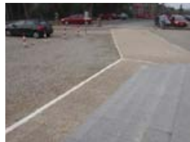
Hospital de Leza. Suelo de gravilla en el aparcamiento y acceso.
