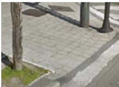
Señalización táctil en paso de peatones sin contraste cromático adecuado.
