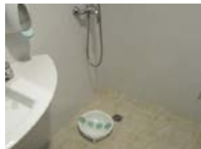
Baño sin plato de ducha, a ras de suelo. No se permite realizar giro, ni hay espacio de transferencia.
