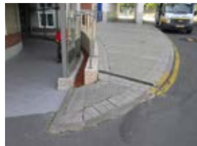
Acceso a urgencias. Pendiente excesiva sin barandillas y ancho insuficiente en acera.
