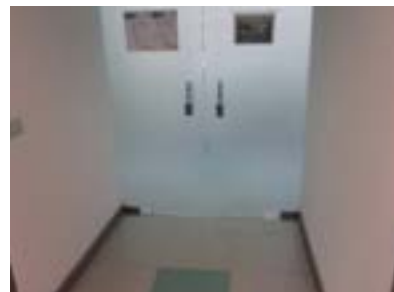
Puerta de acceso a consulta. Paso libre de una hoja inadecuado y no dispone de zócalo protector.
