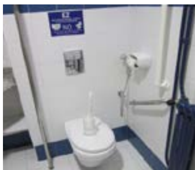
Baño de habitación. Barras asideras instaladas inadecuadas.
