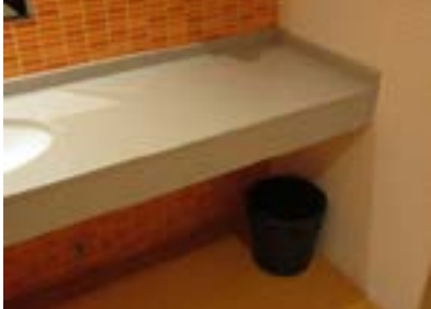
Aseo reservado en la zona de cafetería. Accesorios de lavabo a altura elevada.
