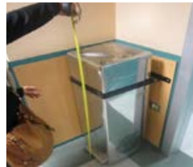
Fuente de agua en hospitalización.
