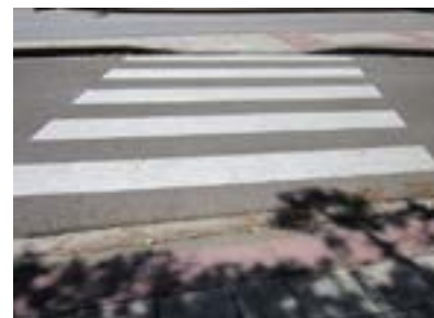
Paso de peatones en el acceso al edificio de consultas externas. Escalón en el vado. No se dispone de franjas señalizadoras táctiles.
