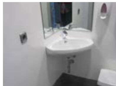
Aseo adaptado en consulta de ecografía. Lavabo y espejo inadecuado. Jabón de manos instalado a altura elevada.
