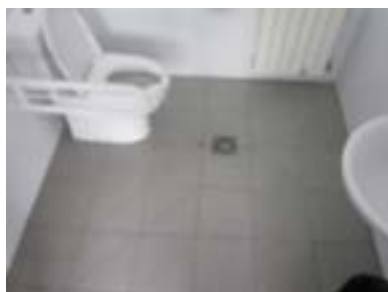
Aseo accesible en cafetería.
