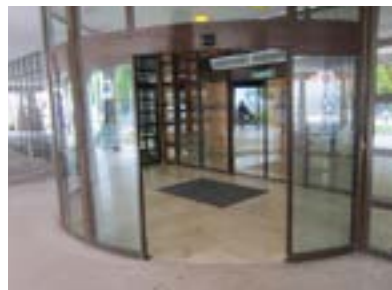
Entrada principal edificio A, bandas señalizadoras inadecuadas.
