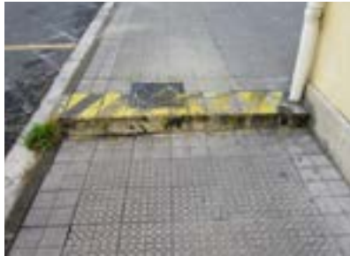
Hospital Santa Marina. Acceso desde la parada de autobús. Escalón aislado, peligroso, inaccesible.
