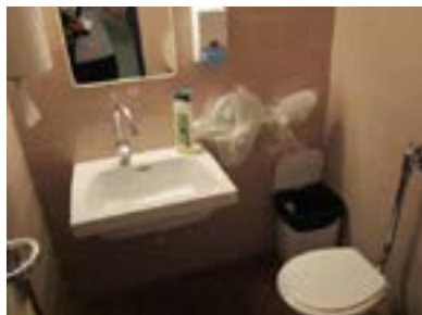
Aseo unidad de radiología, sin adaptar.
