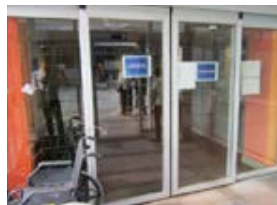
Puerta de acceso de vidrio, sin bandas señalizadoras.
