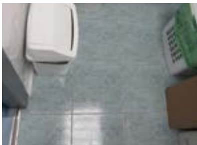
Aseo tipo. Consultas planta baja calle La Esperanza. Inaccesible.
