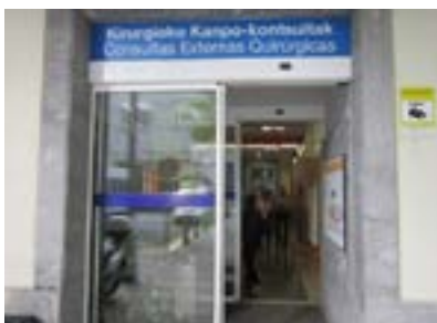
Puerta de entrada a consultas externas quirúrgicas. Ancho libre de paso inadecuado y bandas señalizadoras instaladas inadecuadamente.
