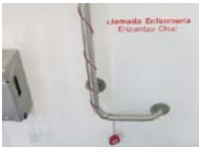
Alarma inutilizada en aseo adaptado.
