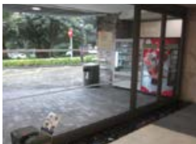
Puerta de acceso a urgencias sin bandas señalizadoras adecuadas.
