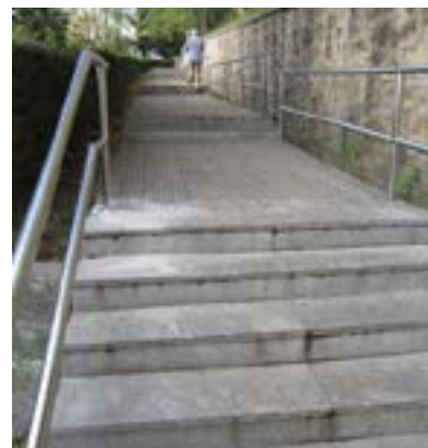
Escaleras de acceso desde el aparcamiento a la entrada principal. Falta señalización en escalones y tramos de pasamanos.
