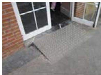
Puerta de acceso a la residencia. Puerta con anchura inadecuada y rampa con demasiada pendiente.
