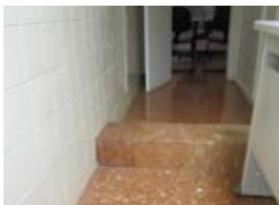
Hospital Vithas San José. Consulta inaccesible. Escalón aislado.
