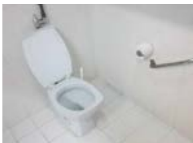
Aseo adaptado sin barras asideras en el pabellón Arrupe.
