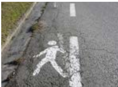
Itinerario peatonal sin protección desde Usurbil.
