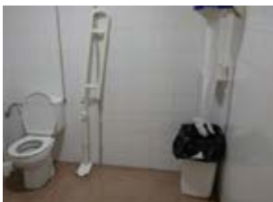
Aseo adaptado zona urgencias. Inodoro inadecuado, altura accesorios de aseo inadecuado.
