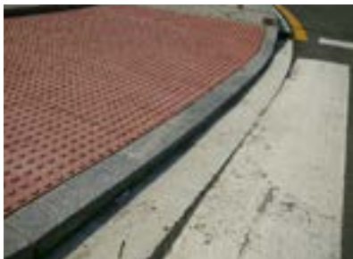
Escalón pronunciado en vado de paso peatonal. Calle Goieta.
