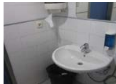
Aseo reservado. Accesorios de lavabo instalados inadecuadamente.
