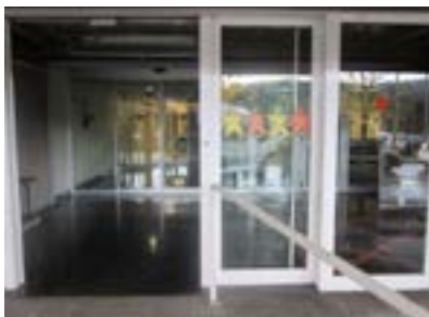
Puertas de acceso a rehabilitación sin bandas señalizadoras y pavimento resbaladizo.
