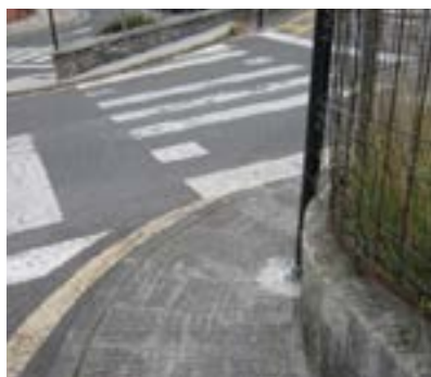
Acera estrecha en acceso al hospital.
