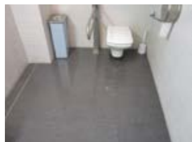
Aseo adaptado. Inodoro a altura inadecuada, barras asideras instaladas inadecuadamente y puerta del aseo apertura hacia dentro.
