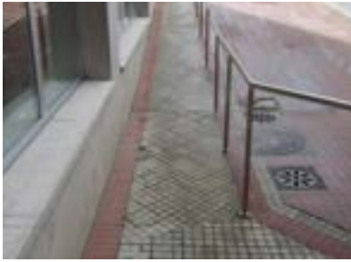
Rampa de acceso a la planta baja. Estrecha, inaccesible.
