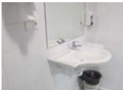
Aseo reservado. Accesorios de lavabo instalados a altura elevada.
