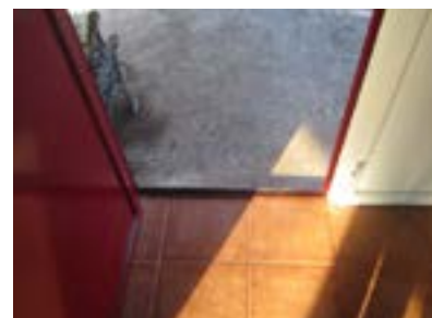
Acceso a la caseta de visitas del jardín. Ancho libre inadecuado y escalón en acceso.
