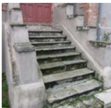
Hospital Psiquiátrico de Bermeo. Escaleras sin pasamanos y en mal estado.
