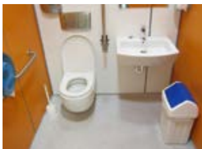
Aseo adaptado boxes urgencias. No se dispone de espacio de trasferencia al inodoro.
