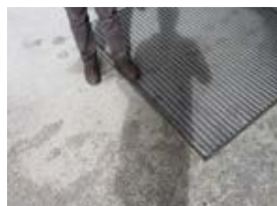
Felpudo en mal estado (crea cejas, que pueden causar tropiezos) en acceso a la entrada principal.
