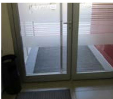
Puerta de acceso desde la calle Arana. No dispone de zócalo protector. Tirador en toda la puerta que causa enganches.
