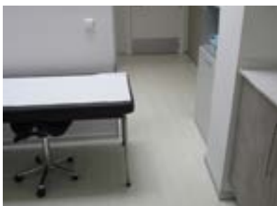
Consultas acceso calle Arana. Estrechamiento por pilar para acercarse a la camilla.
