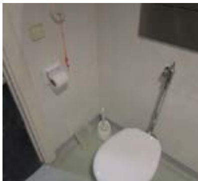
Baño de habitación. No dispone de barras asideras en ambos lados y la alarma se encuentra mal instalada.
