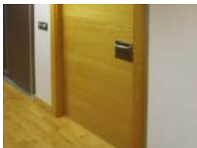
Aseo adaptado características interiores adecuadas, por el contrario, puerta apertura hacia dentro.
