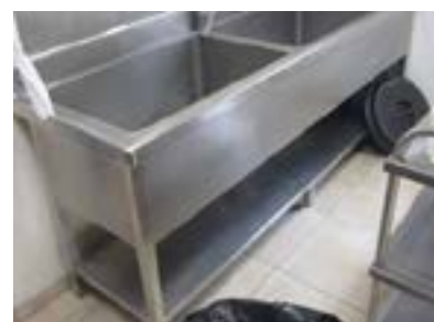
Comedor. Zona de lavabo y lavabo inaccesibles.
