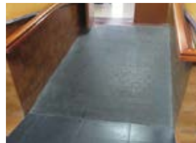
Cafetería. Rampa de acceso con pendiente pronunciada.
