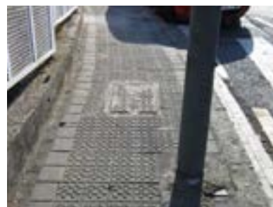
Acera estrecha con mayor estrechamiento por la farola.
