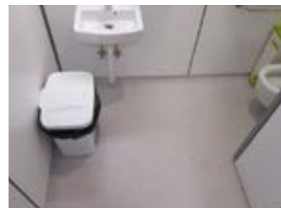
Aseo reservado. Espacio de giro insuficiente.
