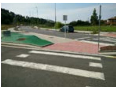
Paso de peatones con escalón pronunciado en vado y pavimento poco táctil instalado inadecuadamente.
