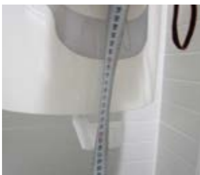
Papel secamanos a altura elevada en aseo de reciente construcción.
