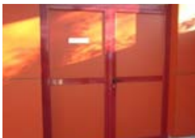
Acceso a Sala Polivalente, no hay señalización.
