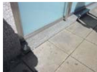
Hospital Quirón. Entrada única a consultas externas. Escalón en acceso.
