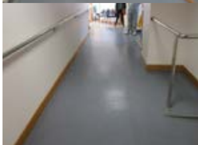
Hospital Universitario Donostia. Edificio Amara. Planta primera. Acceso por rampa con pendiente excesiva.
