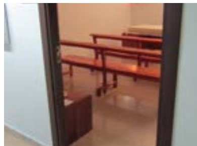
Capilla. Puerta ancho insuficiente.
