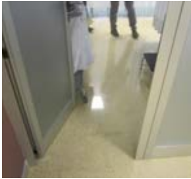
Acceso a consulta con puerta de ancho insuficiente.
