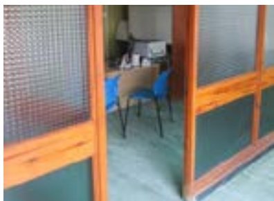
Puerta de acceso de ancho insuficiente en consultas planta baja.
