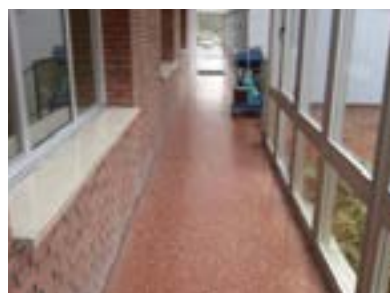
Pasillo de acceso a la entrada principal de la clínica, sin ancho libre adecuado.
