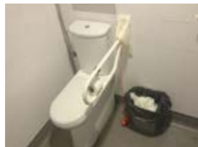
Aseo adaptado sin barra asidera a un lado, espacio de traslado, con obstáculo y alarma rota.
