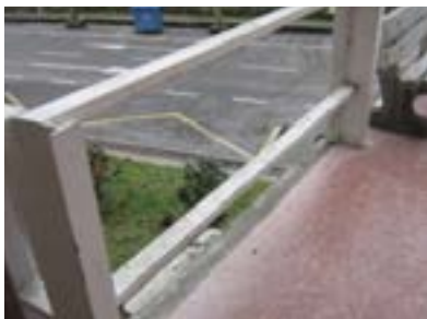
Barandilla de terraza sin protección.
