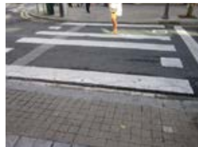
Paso de peatones en la calle Areilza con escalón en vado peatonal. Franjas señalizadoras inadecuadas.
