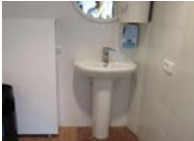
Baño hospital de día. Con muchas deficiencias de accesibilidad, como el lavabo con pie, y accesorios altos.
