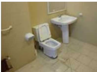
Baño asistido. No dispone de barras asideras ni espacio adecuado para las transferencias.
