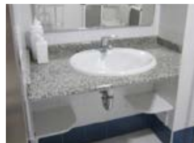
Baño de habitación. Accesorios de lavabo instalados a altura elevada. Baldas que impiden el acercamiento al lavabo.
