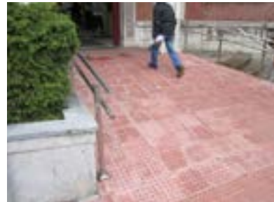
Rampa con pendiente excesiva en acceso al pabellón Arrupe.
