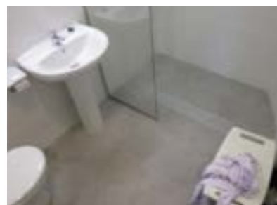
Hospital Psiquiátrico de Bermeo. Lavabo con pie.
