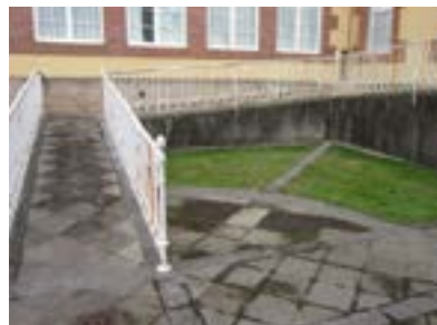
Rampa de acceso a la residencia. Rampa con características inadecuadas.
