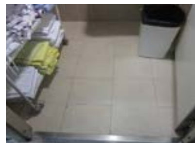
Ducha con lavabo accesible en zona común de hospitalización. Utilizado como almacén.
