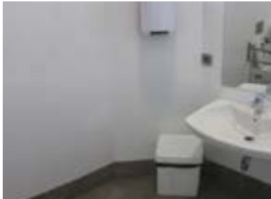
Papel secamanos y espejo instalado inadecuadamente.
