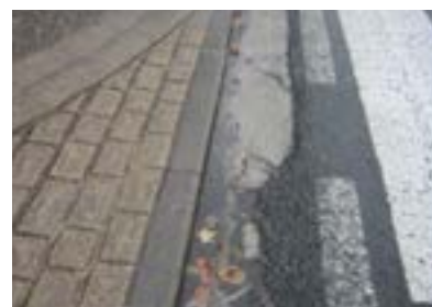
Vado peatonal deteriorado en acceso a la parada de autobús.
