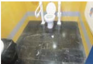
Aseo adaptado. Inodoro inadecuado y puerta con apertura hacia dentro.
