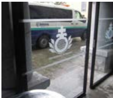
Puerta de acceso a rehabilitación sin bandas señalizadoras adecuadas.
