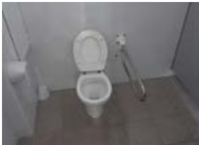
Baño con adaptación deficiente en habitación.
