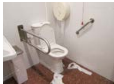
No hay espacio de transferencia al inodoro, ya que está ocupado. Alarma de aviso al personal instalada a altura elevada.
