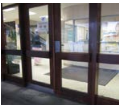
Puerta de acceso a la entrada principal. Ancho libre de paso inadecuado.
