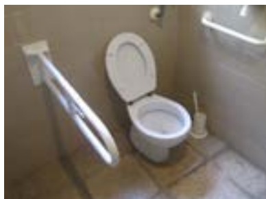
Aseo reservado. Inodoro y fluxómetro inadecuado.
