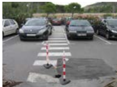
Itinerario con desperfectos en acceso a la entrada principal.
