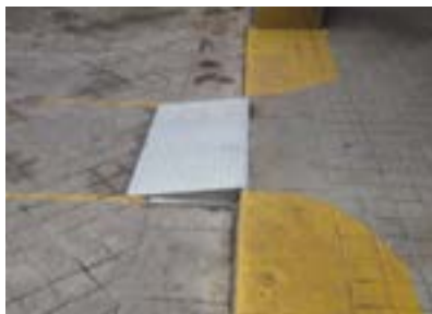
Rampa de acceso al hospital de día. Ancho inadecuado, sin pasamanos.
