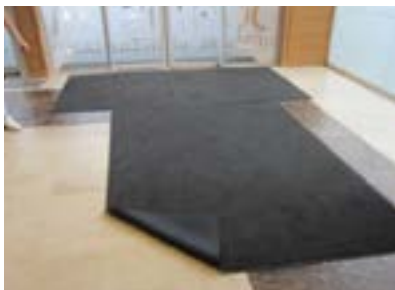
Puerta de acceso edificio Arantzazu. Puertas sin banda señalizadora adecuada y felpudo no fijo.
