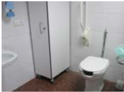
Baño habitación adaptada. Espacio de trasfencia al inodoro insuficiente por ocupación de espacio con el armario.
