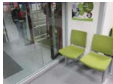
Hospital de Basurto. Edificio Aztarain. Paredes acristaladas sin señalar.
