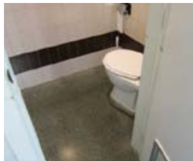
Hospital Santa Marina. Aseo inaccesible.
