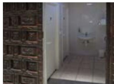
Aseo planta baja. Ninguna adaptación.
