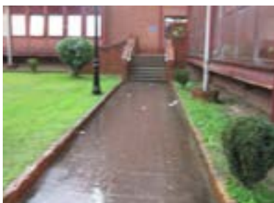
Entrada principal al edificio rojo. Escaleras sin rampa alternativa.
