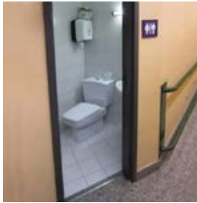
Hospital de Basurto. Edificio Gandarias. Puertas estrechas.
