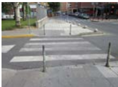
Vados con pendientes excesivas. Calle Balejo.
