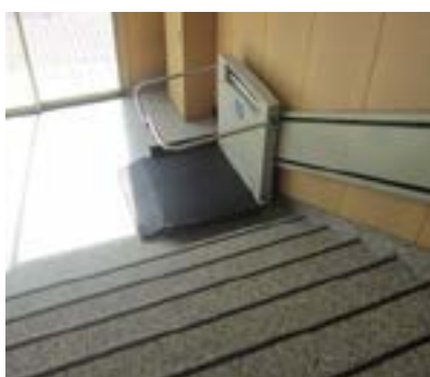
Entrada de la calle La Esperanza. Plataforma elevadora inadecuada.
