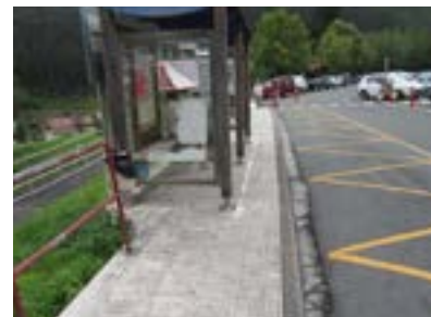
Paso insuficiente a la marquesina, puede resultar una trampa si baja ahí una persona usuaria de silla de ruedas.
