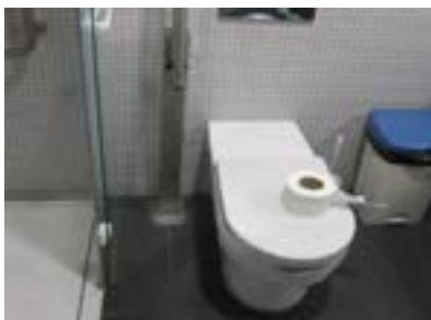
Baño habitación adaptada. Mampara impide transferencia a inodoro.
