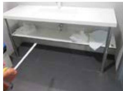
Lavabo tipo. Sin fondo libre adecuado por la balda que se ha colocado.
