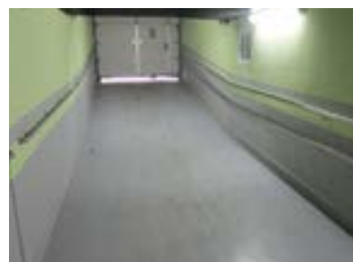
Rampa de acceso a planta sótano desde el exterior. Pendiente elevada.
