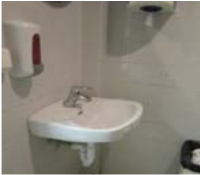
Lavabo sin fondo adecuado, papel secamanos y espejo instalados a altura elevada.
