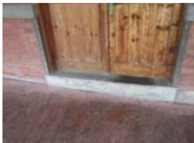
Escalón en acceso a la cocina.
