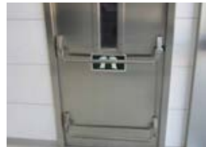
Hospital Txagorritxu. Edificio de consultas externas. Puerta de emergencia. Barra a doble altura.
