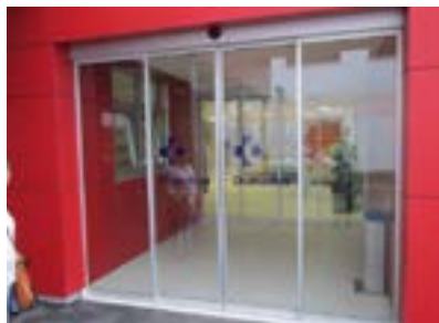
Puertas de vidrio sin bandas señalizadoras.
