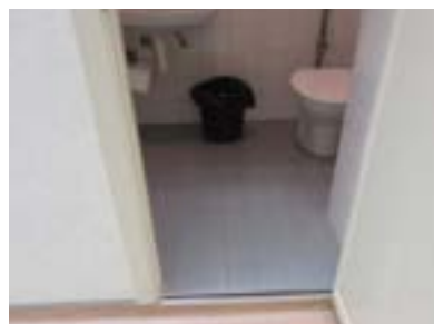
Aseo área Radiología. Escalón en acceso, inaccesible. Edificio Arantzazu.
