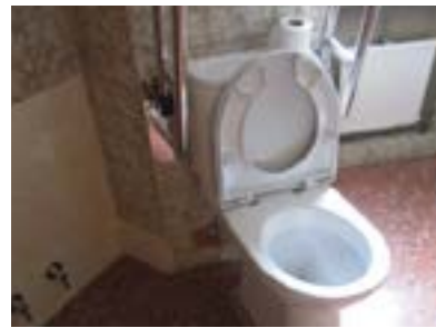
Aseo adaptado planta tercera, muy deficiente.
