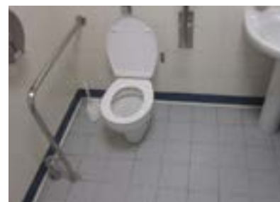
Aseo reservado. Inodoro y lavabo inadecuados. Barra asidera que obstaculiza el acceso al inodoro.
