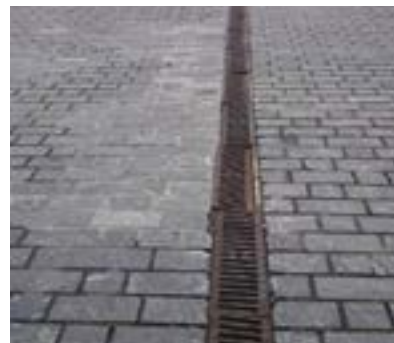
Sumidero lineal deteriorado en el acceso a admisión.
