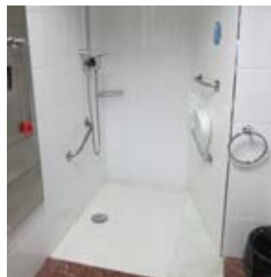
Baño habitación adaptada. Ducha de dimensiones reducidas, sin asiento de transferencia y alarma instalada a demasiada altura.
