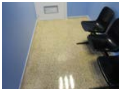
Sala de espera. Dimensiones reducidas, no permite realizar giro a las personas usuarias de silla de ruedas, ni tiene área para colocarlas.
