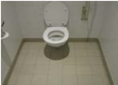
Aseo reservado en la planta primera. No dispone de barra asidera a un lado, ni espacio de transferencia.
