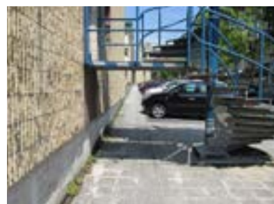
Paso a UCI-UCA. Altura libre inadecuada.
