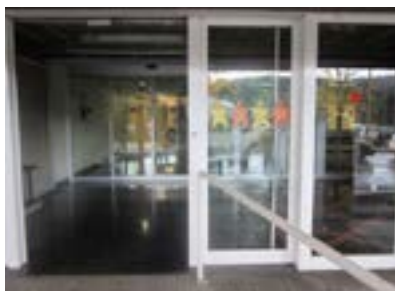
Errehabilitaziora sartzeko atek ez daukate seinaleztapen-bandarik, eta zoladura irristakorra da.
