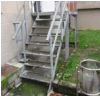
Bermeoko ospitale psikiatrikoa. Kontramailarik gabeko eskailera. Eskailera-maila estuak.
