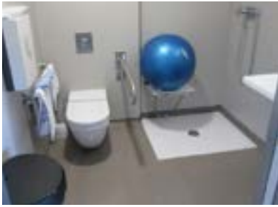
Erditzeko gela. Komun-zuloa altuera ezegokian; dutxan, heldulekuak falta.
