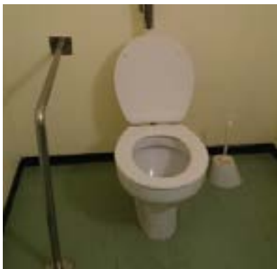
Erradiologia-kontsultako komuna. Barra ezegokia, eta beste barra bat falta da.
