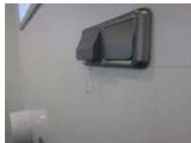
Komun egokitua. Alarmaren eskulekua ezegokia da.
