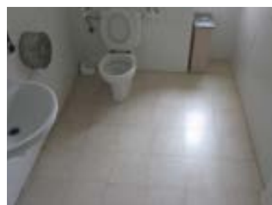
Lagundutako komuna, beheko solairuan. Komun- zuloa altuera ezegokian.
