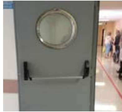
Orri bikoitzeko atearak zabaleraz ezegokiarekin, eta beste barra bat falta zaie beherago.
