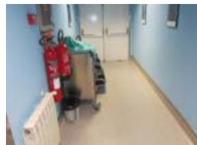
Gurutzetako ospitalea. Eraikin nagusiko korridorea. Itxarongela gisa erabiltzen da, korridorea gehiegi estutzen da eta ezin dira gurpil-aulkien erabiltzaileak sartu jendea eserita baitago.
