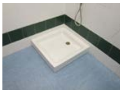
Errehabilitazioan ezinduei gordetako aldagelako dutxa iristezina da.
