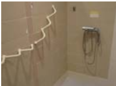
Bermeoko ospitale psikiatrikoa Jauzi-iturriaren altuera aldatzeko barra falta da aldatzeko.
