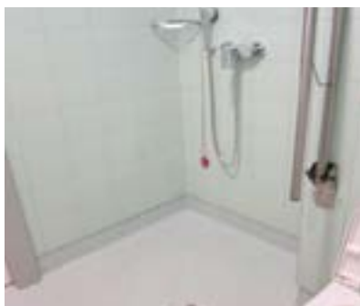
Logela egokituko dutxa. Heldulekuak falta. Duxtaren altuera aldatzeko barra falta da.
