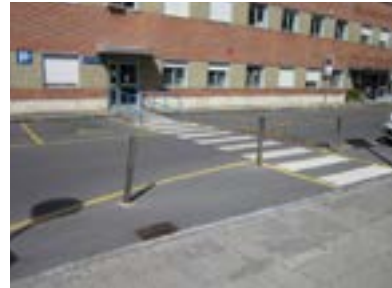
Ezinduei gordetako aparkalekua. Kanpoko kontsuluten eta kafetegiaren zonaldea. Seinaleztapen bertikala falta da.
